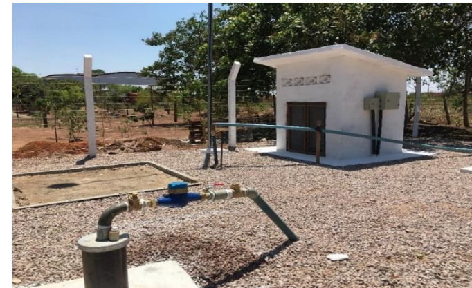
Perfuração e implantação de poços tubulares profundos para captação de água subterrânea nos municípios de Pontes e Lacerda e Vila Bela - Lote 04
