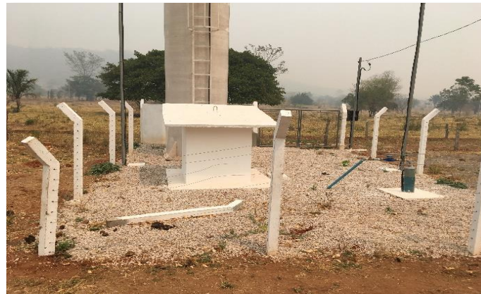
Perfuração e implantação de poços nos municípios de Rio Branco, Curvelândia e Cáceres - Lote 01
