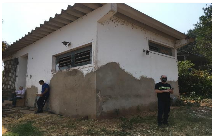
Reforma geral da Estação de Tratamento de Água (ETA) no município de Barão de Melgaço
