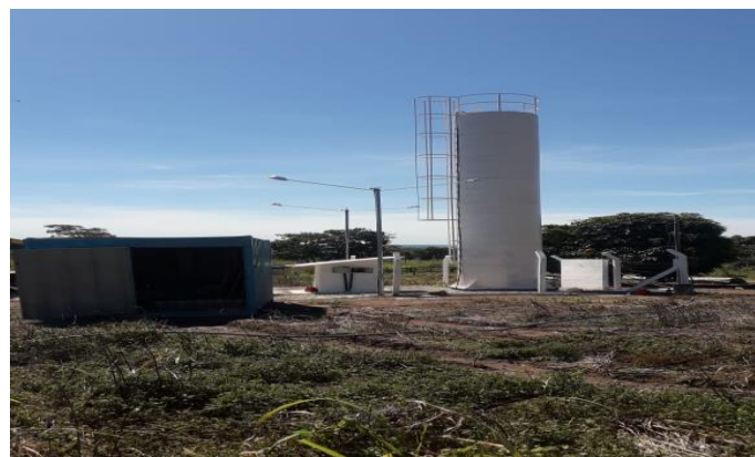
Perfuração e implantação de poços nos municípios de Mirassol d'Oeste, Glória d'Oeste e Porto Esperidião - Lote 03
